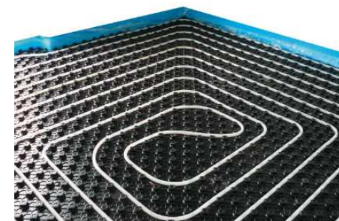
Sistema radiante a pavimento
